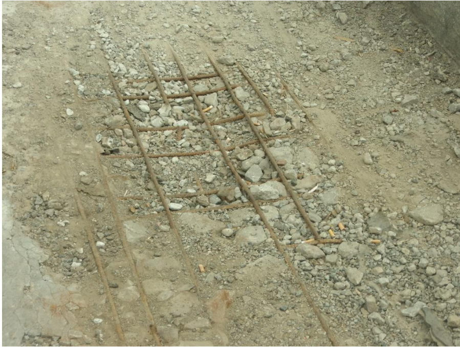
Fot. 2 Luźne skorodowane fragmenty betonu na płycie. Ubytki w płycie pomostowej. Odślonięte zbrojenie.
