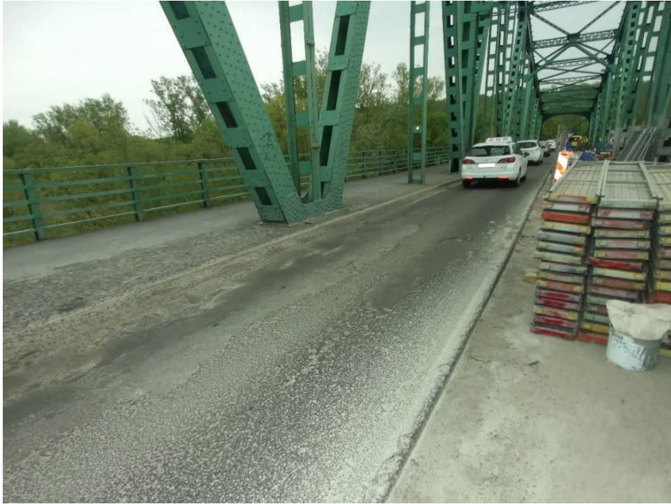
Fot. 9 Ubytki i spękania nawierzchni
