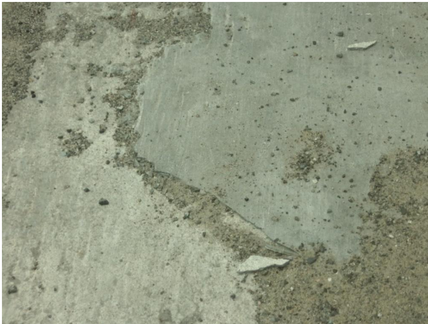
Fot. 5 Odsypająca się od podłoża warstwa wyrównawcza (naprawcza) wykonana z betonu PCC
