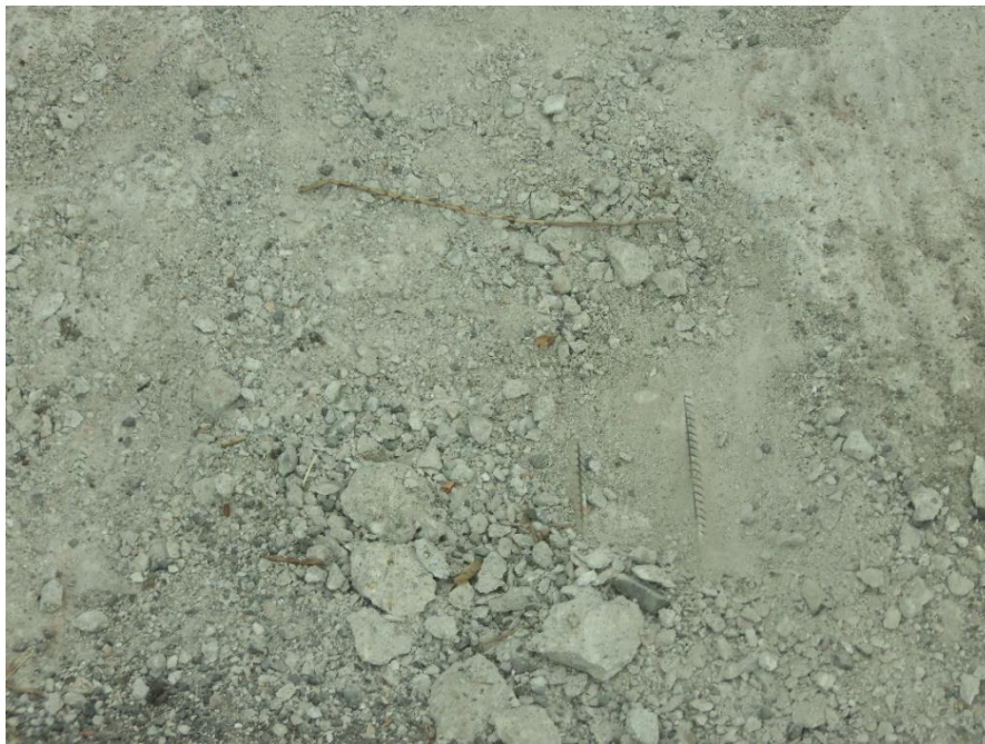
Fot. 1 Luźne skorodowane fragmenty betonu na płycie.
