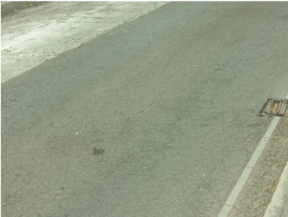
Fot. 10 Spękania nawierzchni
