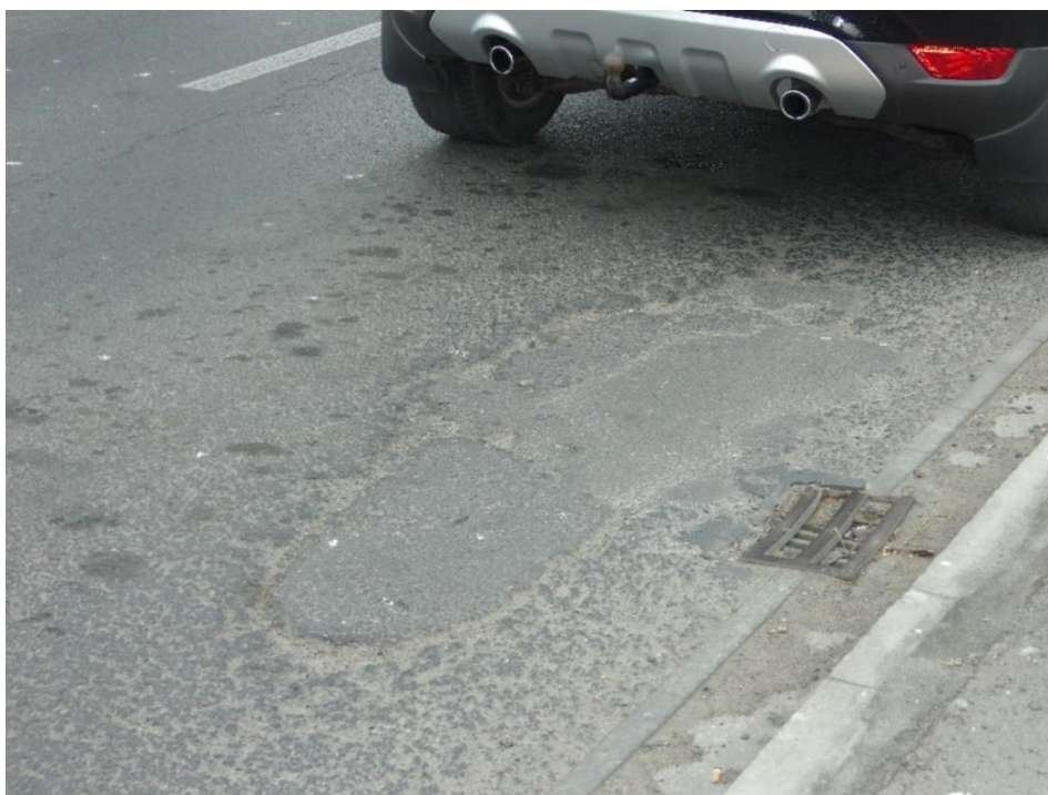
Fot. 8 Ubytki w nawierzchni
