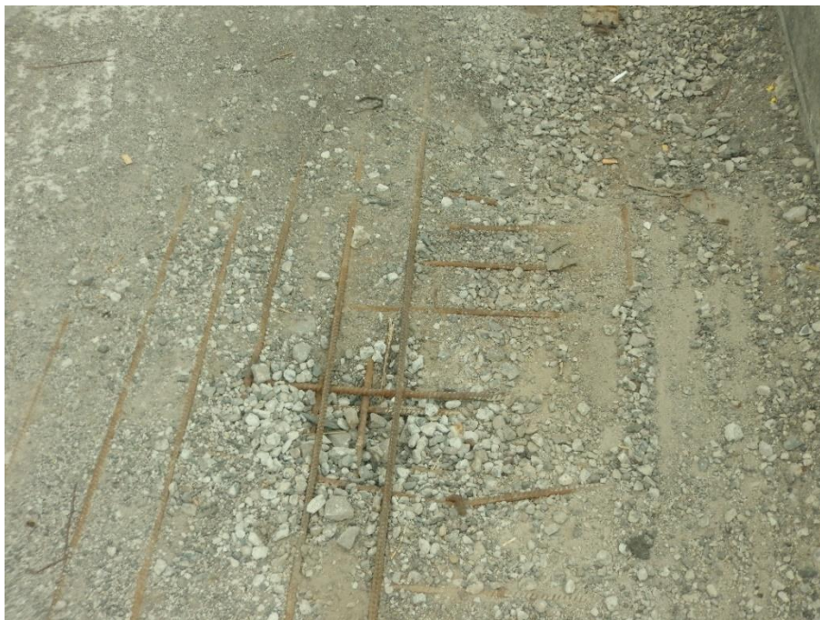
Fot. 3 Luźne skorodowane fragmenty betonu na płycie. Ubytki w płycie pomostowej. Odślonięte zbrojenie.
