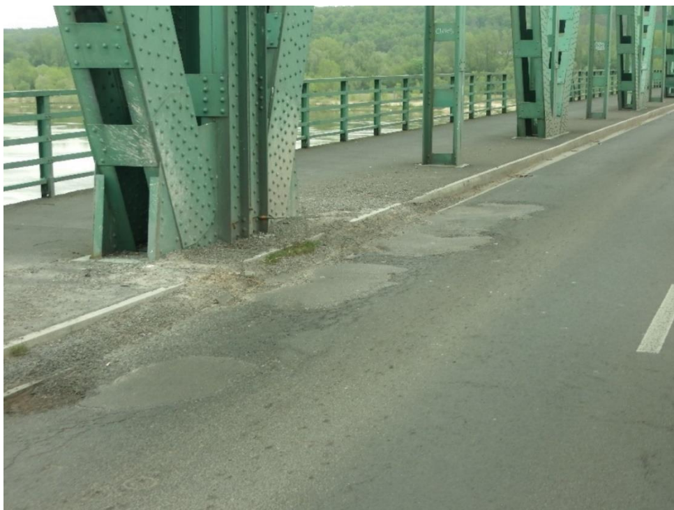
Fot. 7. Zniszczona nawierzchnia, z widoczną lokalną naprawą.
