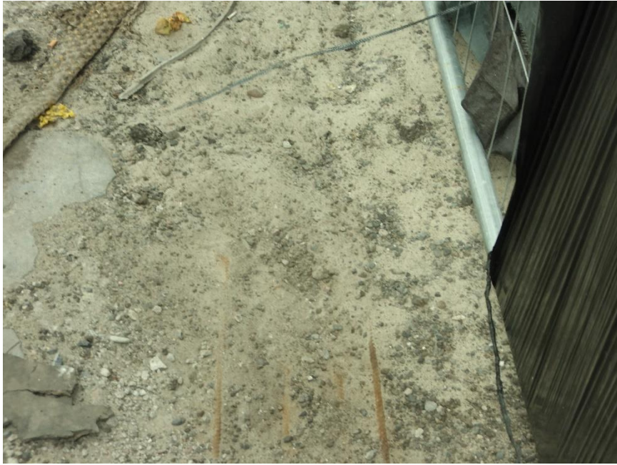
Fot. 4 Skorodowana powierzchnia betonu
